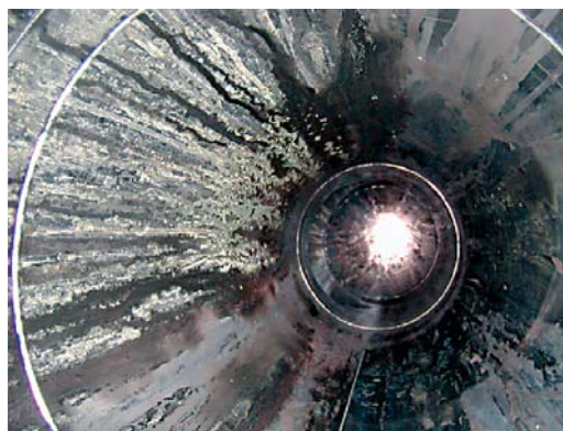
Ilustracija 3 Začepljen dimnovodni kanal
