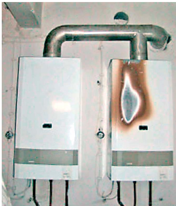
Ilustracija 2 Nedovoljno dimenzioniran dimnovodni kanal (zbog naknadnog spajanja dodatnog uređaja)
